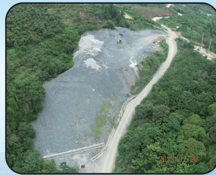
百色水库灌区工程总干渠福禄弃渣场存在顺坡溜渣隐患
